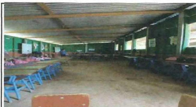
Foto 3: se cambiaran vigas de madera por costaneras y así mismo se cambiaran las laminas.
